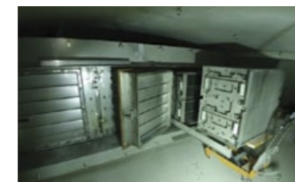
부산 치마산터널 ESP System
