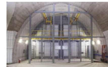
강남순환고속도로 터널 ESP System
